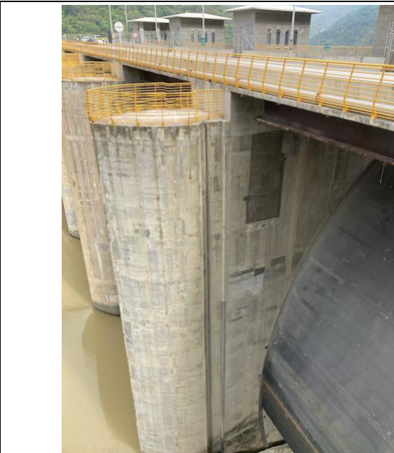
Foto 38: Compuertas de aliviadero
