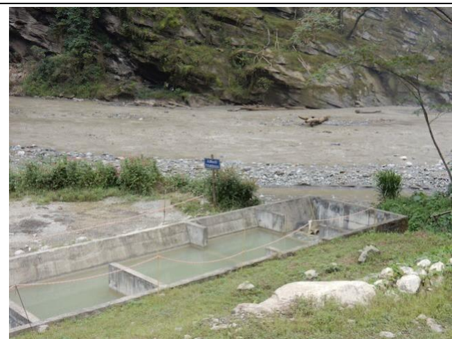
Foto 43: Tratamiento de aguas de drenaje de galería de presas
