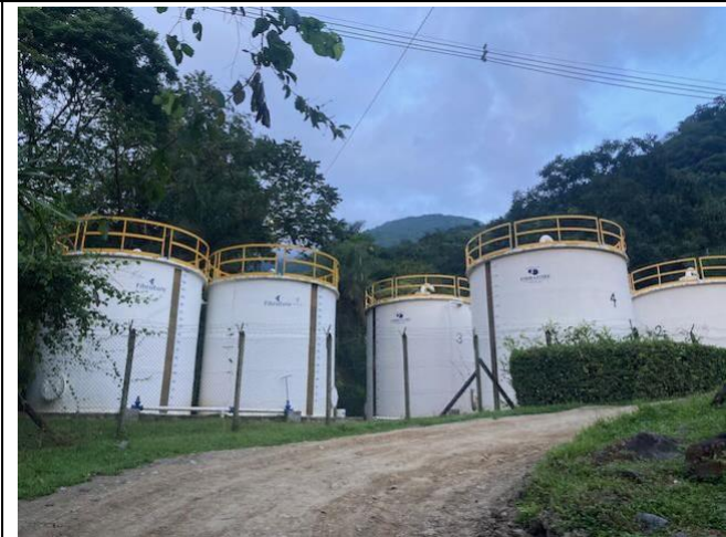
Foto 54: Almacenamiento de agua potable campamento EPM
