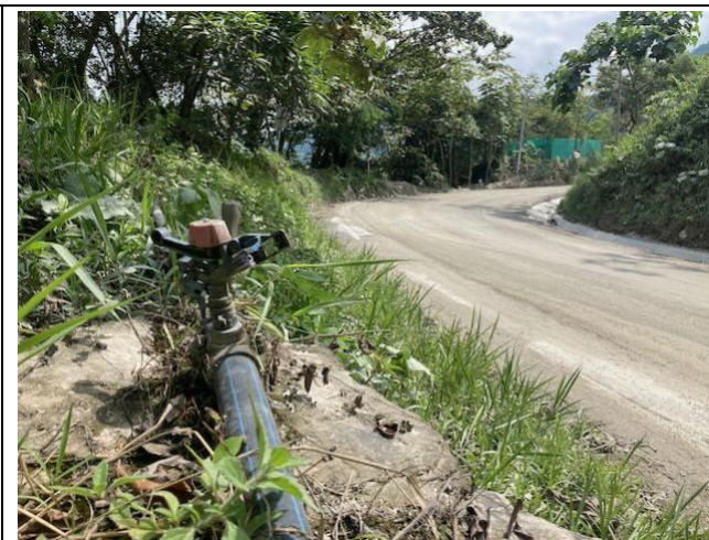
Foto 45: Sistema de rociadores para suprimir el polvo en las principales carreteras de construcción
